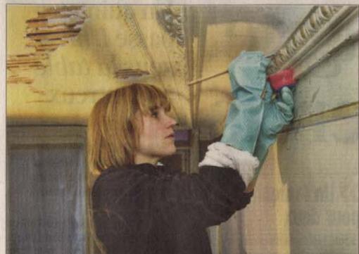
TRAVAIL MINUTIEUX Mijanou Gold retrouve un à un les ornements dorés de la frise du plafond. La restauration permet de les mettre en valeur.
